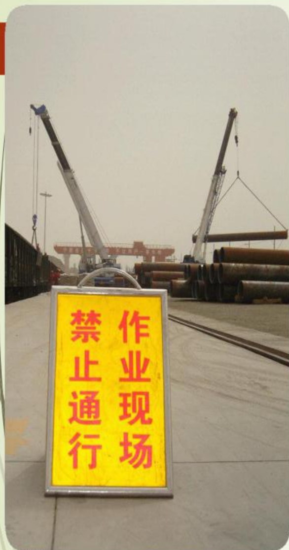
吊装现场要有警示
